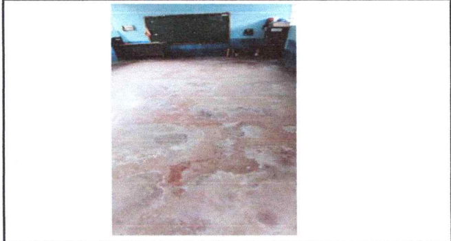
Foto 1: PISOS EN MAL ESTADO Y PUNTURA DEL AULA
