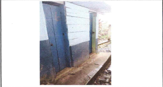
Foto 2: SANITARIOS EN MAL ESTADO
