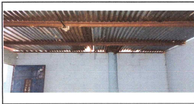
Foto 6: TECHO DE AULA EN MAL ESTADO
